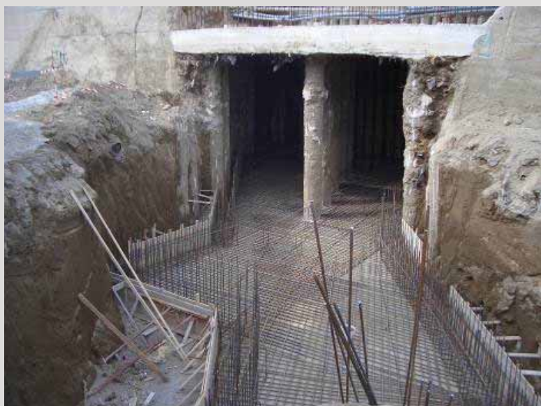
▲ Maire de Naples – Commissaire Extraordinaire Urgence Sous-sol – Travaux de construction de l'évacuateur du collecteur d'égout de la rue Epomeo (2008-en cours de réalisation)
