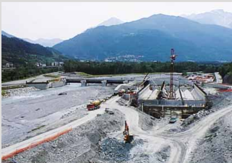
▲ IRIDE ENERGIA S.p.A. (TO) – Pont Ventoux scrl - Travaux de construction du barrage fluvial de la Doria Riparia à Pont Ventoux pour l'installation hydroélectrique Pont Ventoux – Susa (1993-2004)
