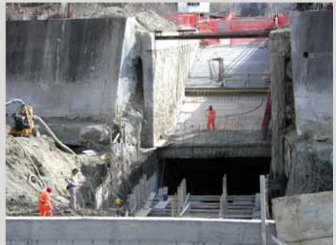
▲ AIPO - Magistrato per il Po - Comune di Nizza Monferrato Construction de la nouvelle confluence entre le torrent Nizza e le fleuve Belbo (1999-2004)
