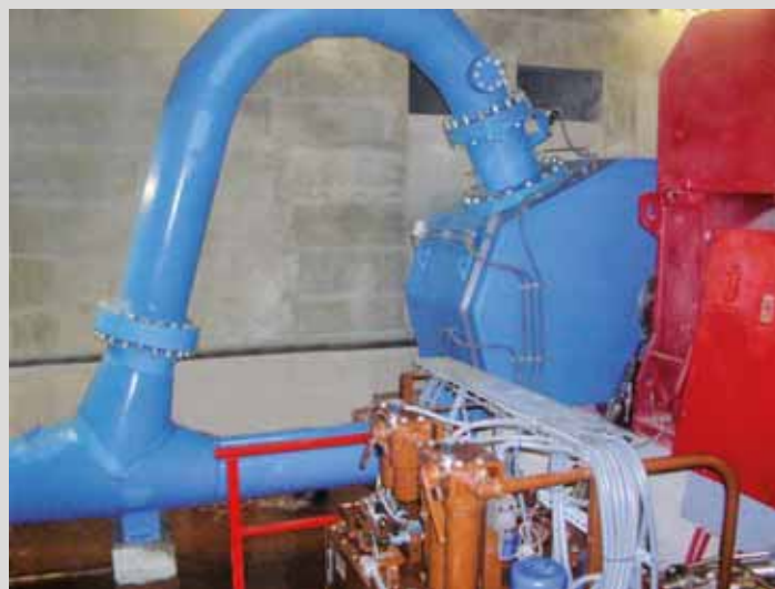
▲ ECOWATT srl – Turbine pour l'installation idroelettrique Val Rezzo a Porlezza (Co) (2006)
